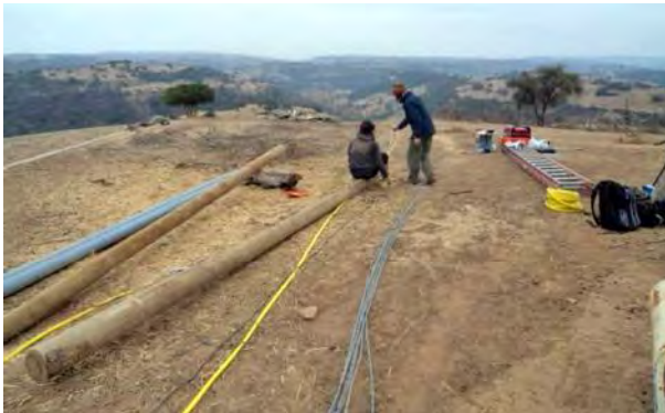
Figura 11. Perforación y preparación de los postes, y del corte del alambre acerado para la estructura "Atrapanieblas".
