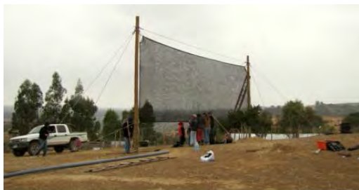
Figura 24. Estructura con la labor de tensión realizada en los alambre acerados, tanto de los vientos, como del que sostiene la malla Raschel.
