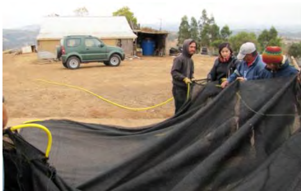
Figura 21. Preparación de la malla Raschel unida a la manguera y alambre acerado, previo a ser instalada entre los postes.
