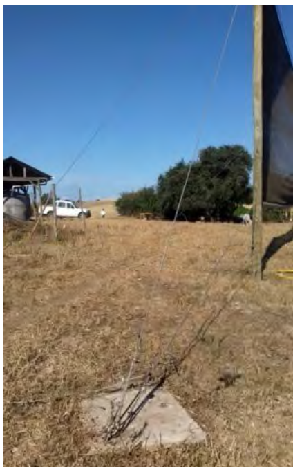
Figura 25. Instalada la estructura "Atrapanieblas", se aprecian los tensores de alambre acerado que sostienen la estructura, y sujetos a estructuras de concreto. INIA-Centro Experimental Hidango, Región de O'Higgins.
